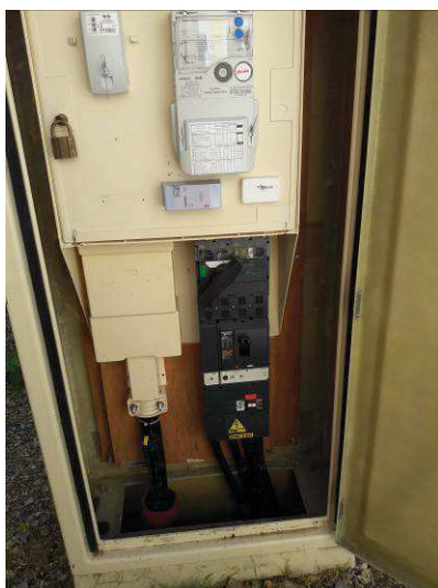
Arrivée basse tension (extérieure)
